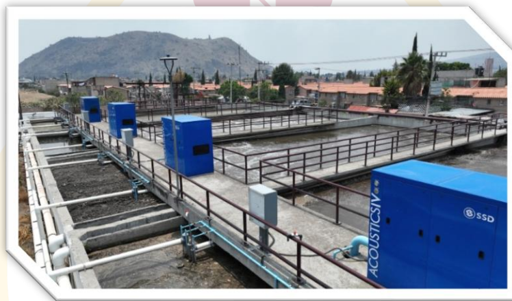
Ilustración 8 "Planta de Tratamiento de Aguas Residuales"
